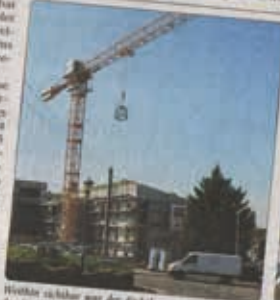
Weithin sichtbar auf der Baustelle über dem Anbau des Bürgerheims in Meerane. Im April nächsten Jahres soll die Fertigstellung sein.
